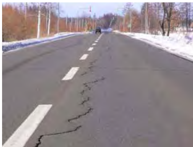
凍上による舗装の亀裂(北海道 上士幌町内) 写真提供: 武田一夫氏(帯広畜産大学)
