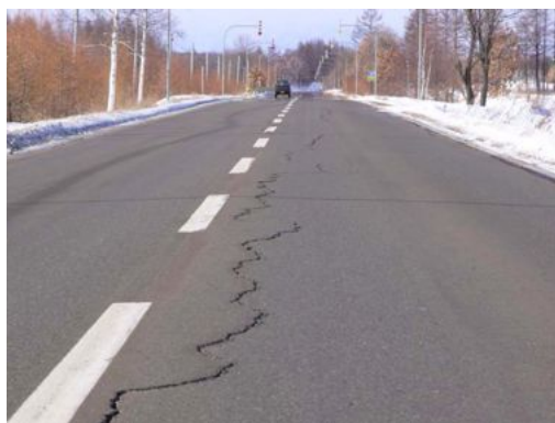
凍土による舗装の亀裂(北海道 上士幌町内) 写真提供: 武田一夫氏(帯広畜産大学)
